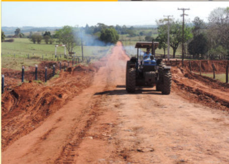
Readequação das estradas Caju e Bom Jesus em sua totalidade. 6,9 km recuperados.
